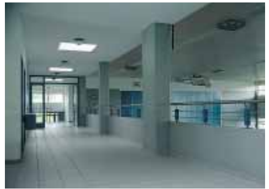
Brüstung einer Galerie: Gesamthöhe 1.1 m, Betonbrüstung mindestens 65 cm, keine Öffnung grösser als \varnothing 12 cm bis auf eine Höhe von 75 cm.
