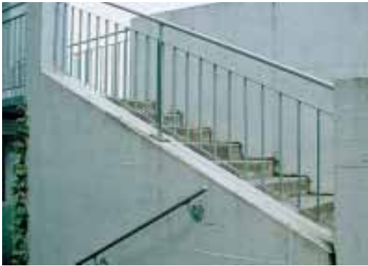
Treppen mit mehr als 5 Tritten: Handlauf zur Unterstützung beim Gehen, Staketengeländer als Absturzsicherung.
