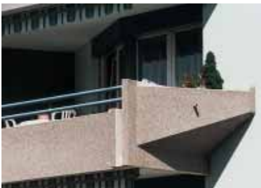
Balkonbrüstung: Betonelemente bis auf eine Höhe von 65 cm, Gesamthöhe der Brüstung 1.0 m, bis auf 75 cm keine Öffnung grösser als \varnothing 12 cm, Oberkante bei den seitlichen Blumentrögen 1.0 m.
