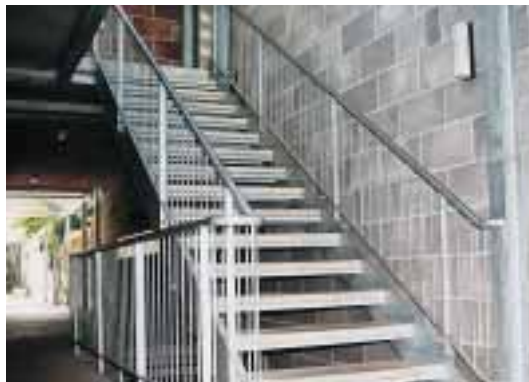
Offene Metalltreppe: Metall-Staketengeländer, Öffnungen bei den Treppenstufen und beim Geländer kleiner als \varnothing 12 cm.
